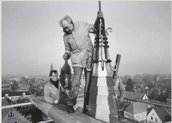
Voorzitter Gerard de Jong herplaatst eind jaren tachtig eigenhandig de haan op de spits van de toren (stichting Stadsherstel Amsterdam).
