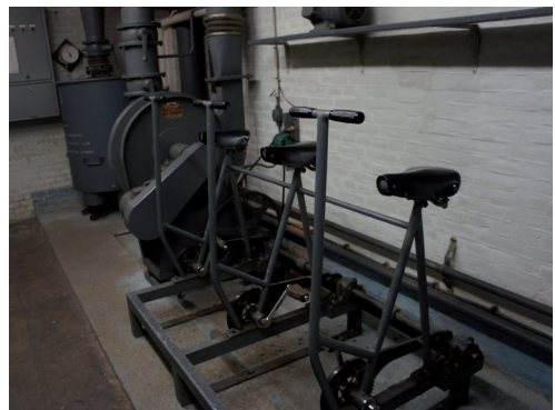
Als de nood het hoogst was... kon eigen elektriciteit door middel van speciale fietsen worden opgewekt (foto Maaïke van Schaik).
